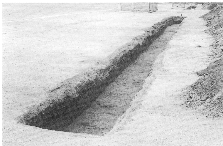
(3) 配線トレンチF区(北から)
