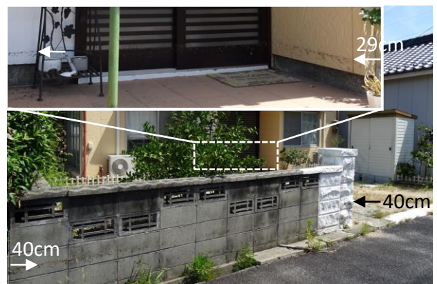
写真 1.3 ブロック塀と玄関における浸水痕
