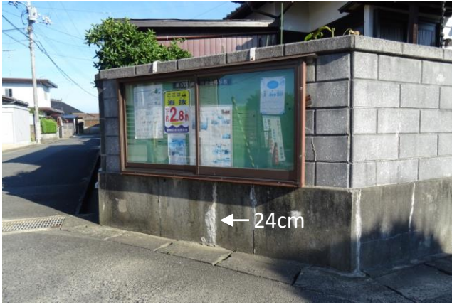
写真 7.1 第17区浜郷自治会の掲示板下の浸水痕跡
