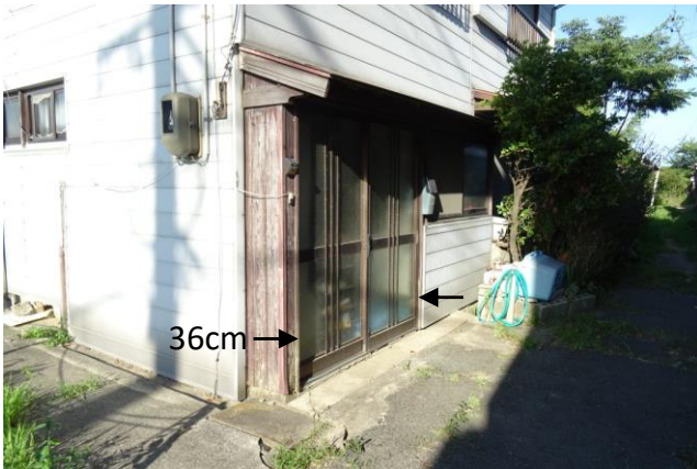
写真 7.2 住宅玄関の浸水痕跡
