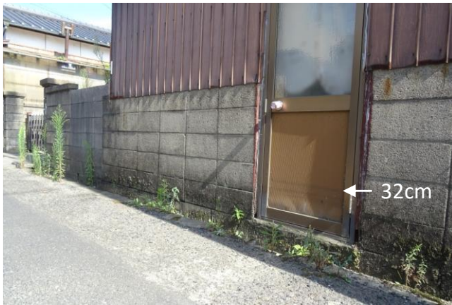
写真 4.1 住宅における浸水痕跡
