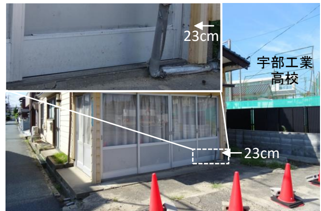
写真 2.2 建物におけるステンレス扉の浸水痕跡
