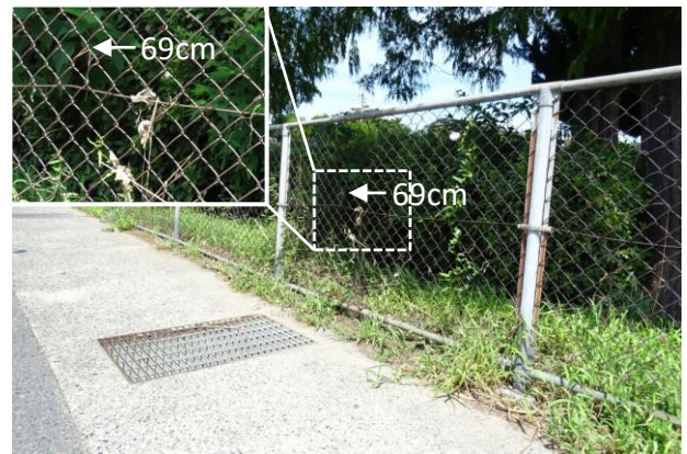
写真 1.1 沼街区公園のフェンスに付着した塵芥
