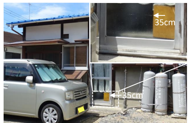
写真 1.4 住宅における浸水痕跡
