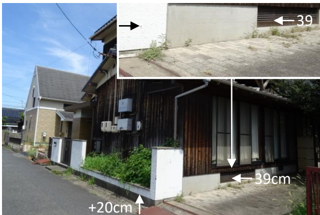
写真 3.2 住宅における浸水痕跡
