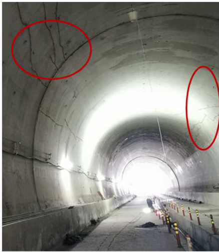
(a) トンネルに発生したひび割れ。 出典：Xu ら (2023) [30] より引用 (CC BY 4.0)
