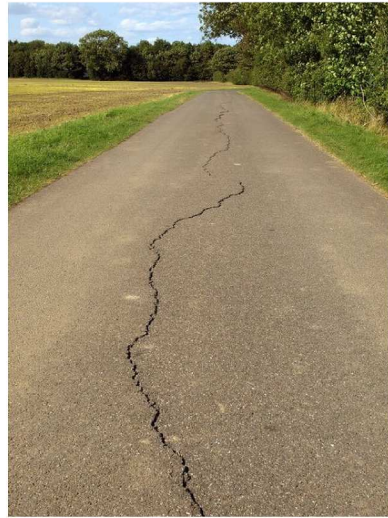
(b) 舗装路面に発生したひび割れ。 出典：Andy Beecroft / A Cracking Road There / CC BY-SA 2.0 ( https://commons.wikimedia.org/wiki/File:A_Cracking_Road_There_-_geograph.org.uk_-_1460260.jpg より引用)
