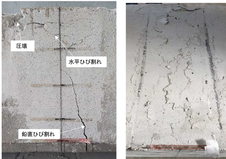
(a) 側面からみた損傷状況
