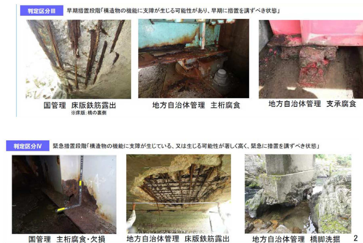
図-1.1.11 橋梁の損傷事例 19)
