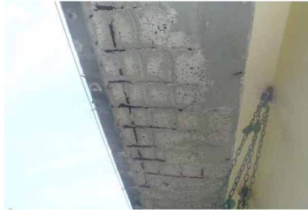
図-1.1.25 劣化した張出床版下面
