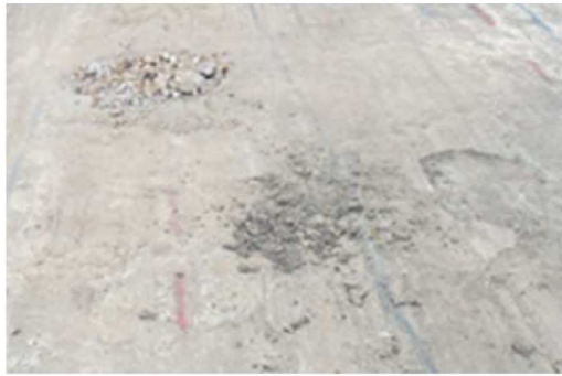
図 1.1.17 床版上面の土砂化 21)
