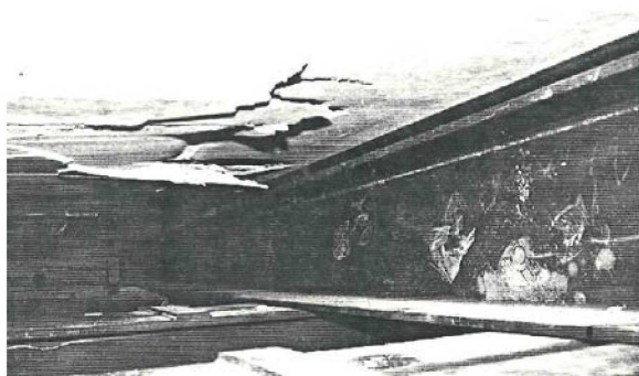
図-3.6.7 リブのせん断破壊状況
