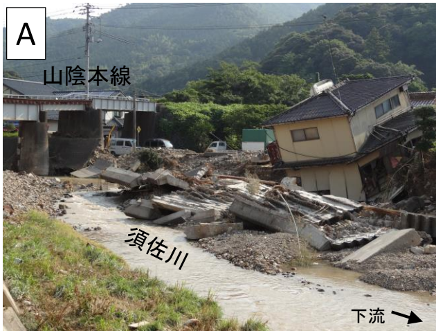
写真 6.A 須佐川左岸堤防の崩落に伴う堤内地の住家被害 (2013年7月31日撮影)
