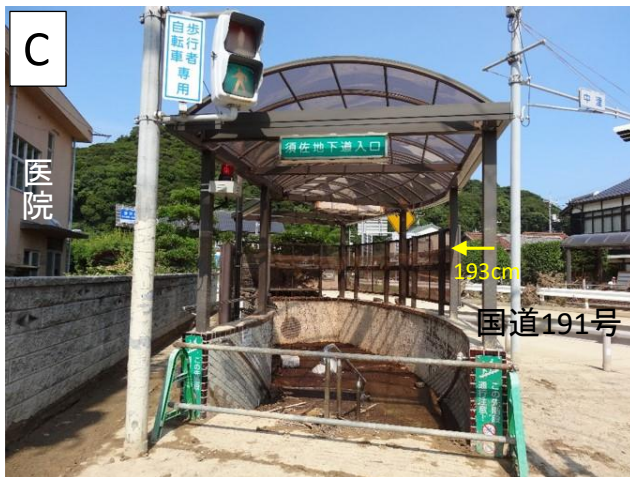
写真 6.C 中津交差点の地下道における浸水被害 (2013年7月31日撮影)
