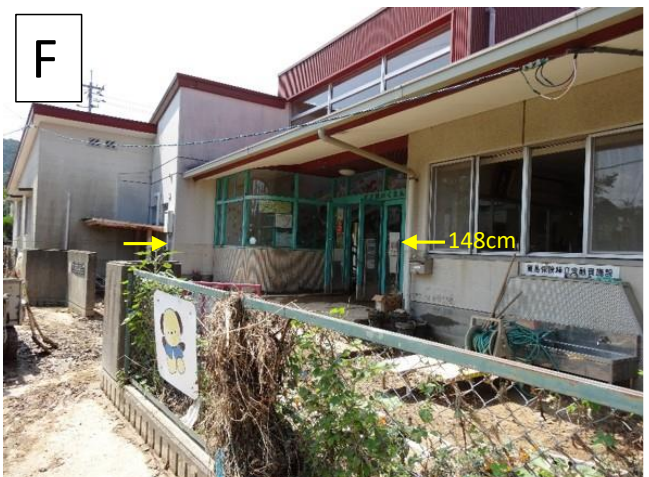
写真 6.F 須佐保育園の浸水被害(2013年7月31日撮影)
