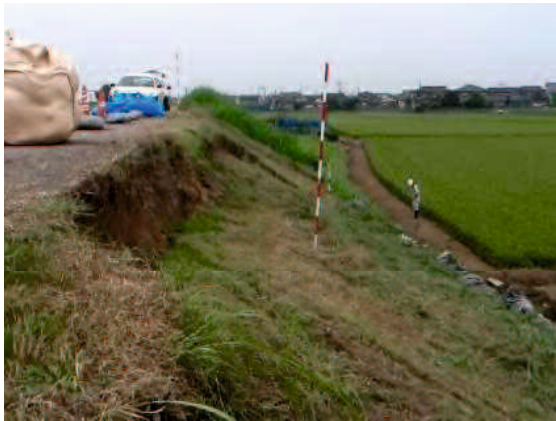
②裏のりすべり状況
