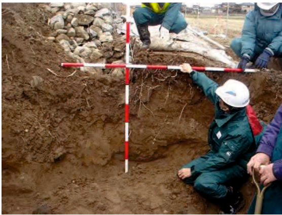
③Acl層の落ち込みと地盤隆起の状況
