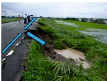
図 2.3.1 被災状況(筑後川、2015年8月) 5)
