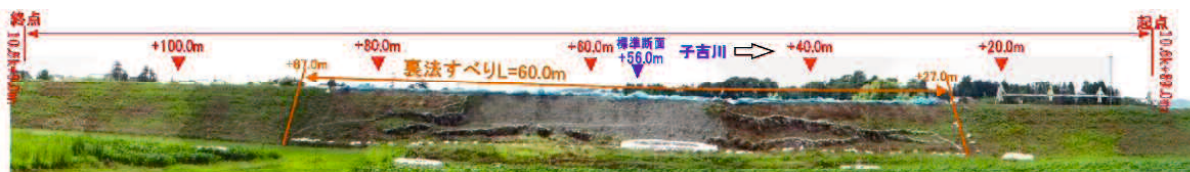
①被災箇所全景
