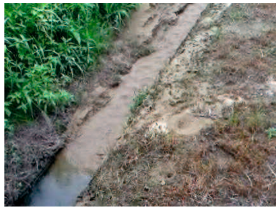
④噴砂状況（側溝に流出した状況）
