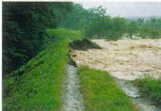
写真 3.1.3 侵食による被災の事例
