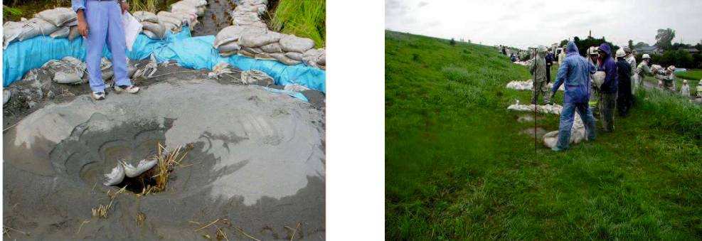
写真3.2.1 被災の状況 2) (左 図3.2.4中、写真①の箇所、右 図3.2.4中、写真②の箇所)
