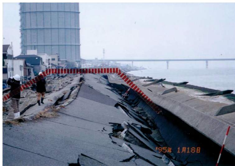
写真 3.1.4 地震による被災の事例
