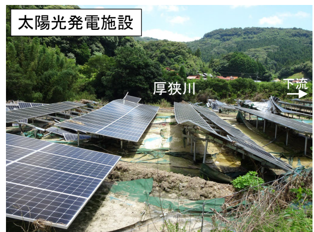
写真 5.18 太陽光発電施設における浸水被害
