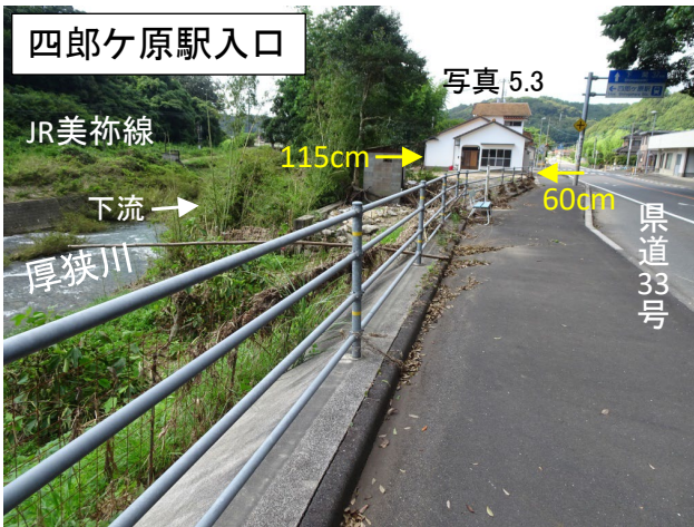
写真 5.2 県道 33 号の四郎ヶ原駅入口における浸水の痕跡（地盤からの高さ、cm）
