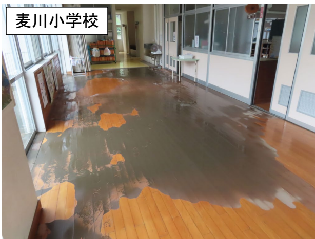
写真 2.7 麦川小学校における職員室（上）と廊下（下）の浸水被害（美祢市立麦川小学校、2023b）
