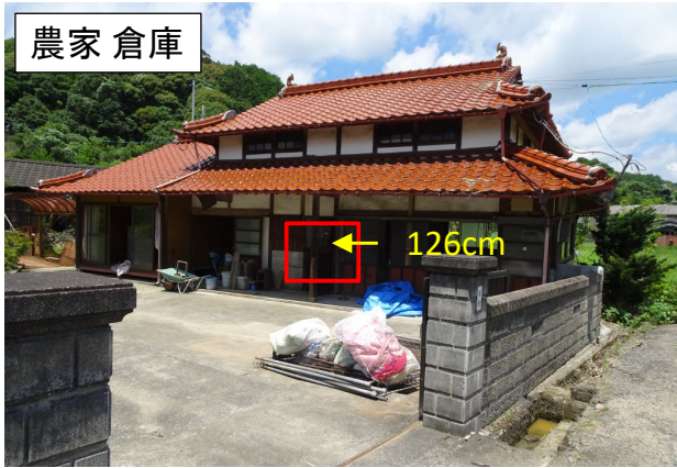
写真 5.13 農家の倉庫における浸水の痕跡（地盤からの高さ、cm）（赤枠は写真 5.14）
