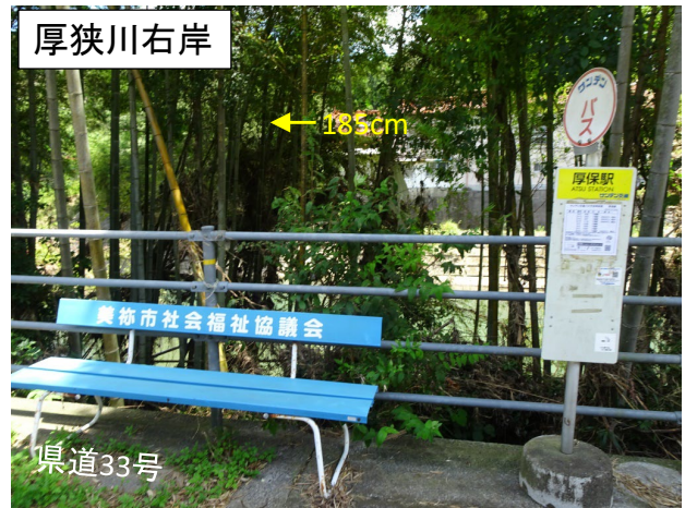
写真 6.1 厚狭駅バス停における浸水の痕跡（地盤からの高さ、cm）
