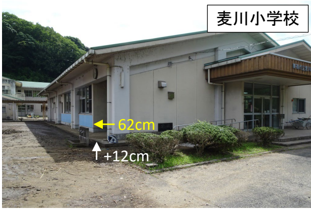
写真 2.6 麦川小学校の校舎における浸水の痕跡 (地盤からの高さ, cm)
