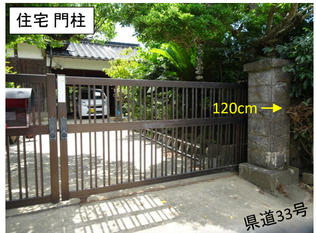
写真 5.4 住宅の門柱における浸水の痕跡（地盤からの高さ、cm）
