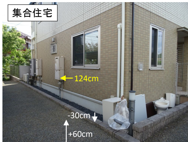
写真1.3 集合住宅における浸水の痕跡（地盤からの高さ、cm）
