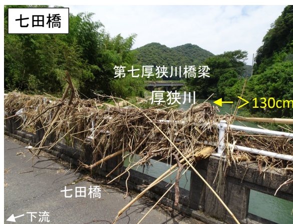
写真 4.5 厚狭川七田橋における欄干への塵芥付着
