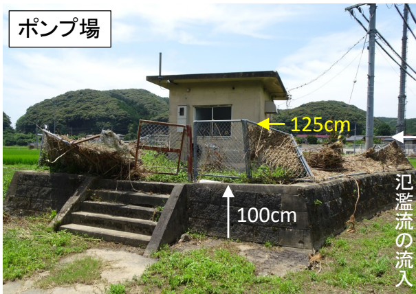
写真 4.3 厚狭川右岸におけるポンプ場の浸水被害
