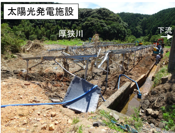
写真 5.17 太陽光発電施設における浸水被害
