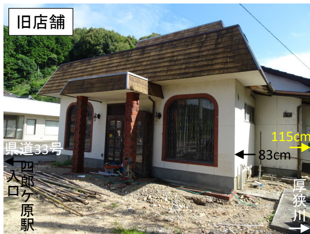
写真 5.3 旧店舗における浸水の痕跡（地盤からの高さ、cm）
