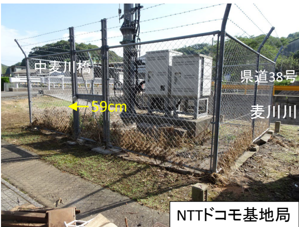
写真 2.3 NTT ドコモの美祢下麦川基地局における浸水の痕跡 (地盤からの高さ、cm)
