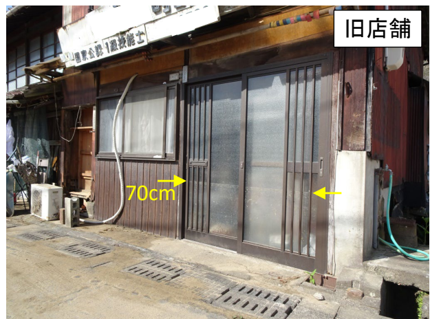
写真 2.1 旧店舗における浸水の痕跡（地盤からの高さ、cm）
