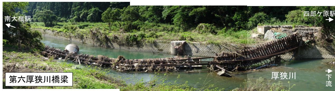
写真 4.8 JR 美祢線における第六厚狭川橋梁の流失被害（南大嶺駅—四郎ヶ原駅間）
