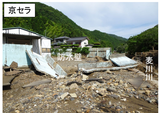
写真 2.9 京セラの工場構内に設置された防水壁の倒壊と浸水被害の状況
