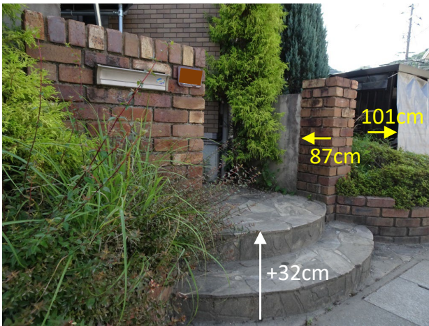
写真 4.5 床上浸水した住宅の浸水痕跡
