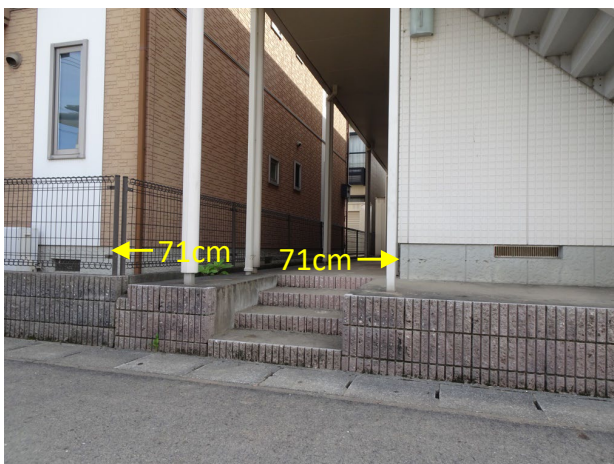
写真 4.6 床下浸水した集合住宅における浸水痕跡
