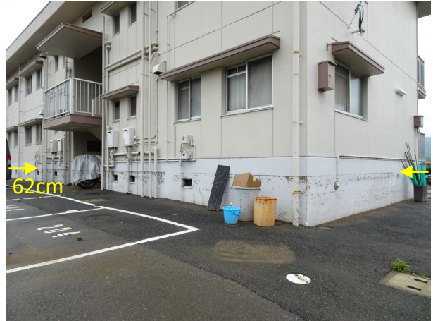
写真 2.17 鴨原における集合住宅の浸水状況 (1日 12時 36分撮影)
