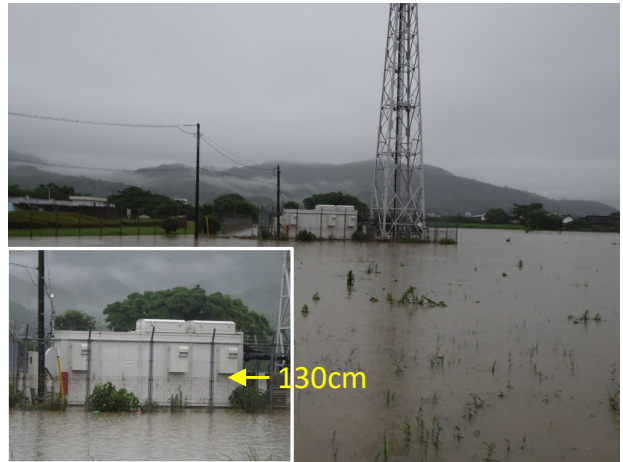
写真 2.2 岩富における NTT ドコモ山口朝田基地局の浸水状況 (1日7時38分撮影)
