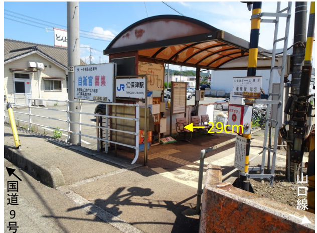
写真 4.8 仁保津駅における浸水の痕跡
