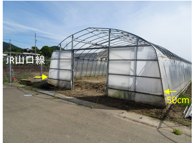
写真 4.7 農業ハウスにおける浸水痕跡
