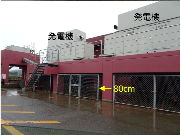
写真 2.1 山口市朝田浄水場における浸水の状況 （1日8時01・03分撮影）
