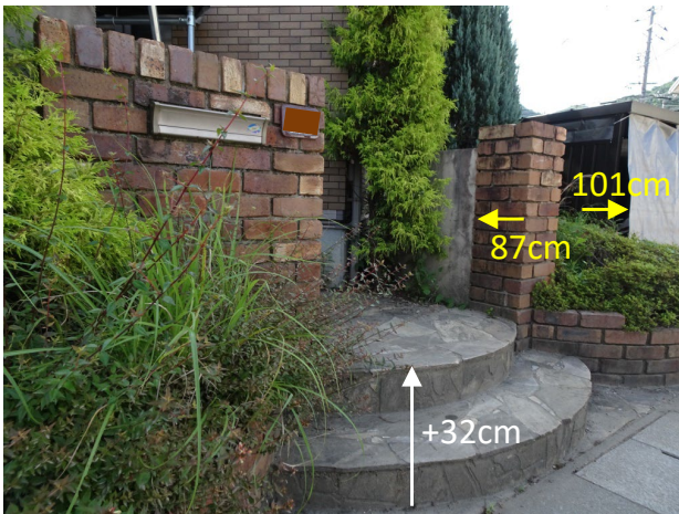
写真 4.5 床上浸水した住宅の浸水痕跡
