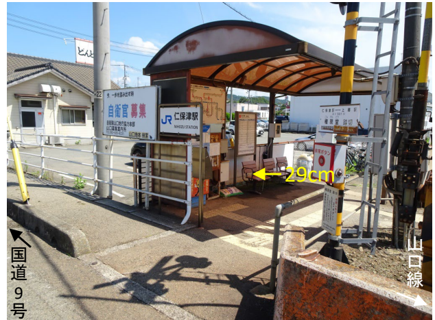
写真 4.8 仁保津駅における浸水の痕跡
