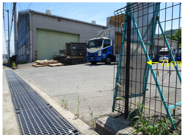
写真 4.9 流通団地における浸水痕跡
