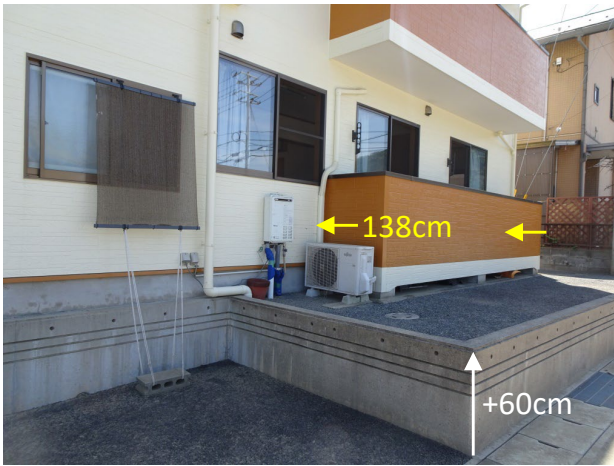
写真 4.4 店舗兼住宅における浸水痕跡
