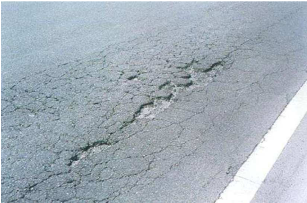
図 1-8 アスファルト舗装で発生したポットホールの例 15)
