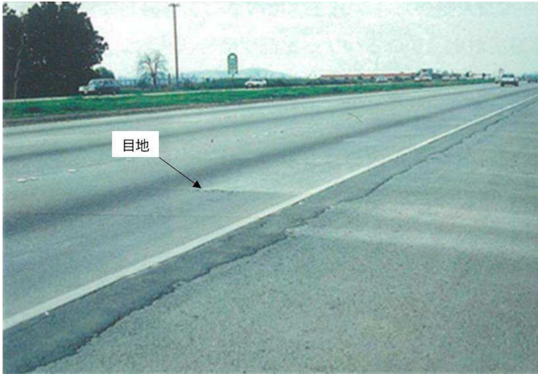
図 1-5 コンクリート舗装におけるポンピング発生状況 10)
