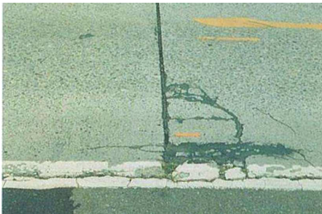
図 1-7 コンクリート舗装の目地部に発生した角欠けの例 10)
