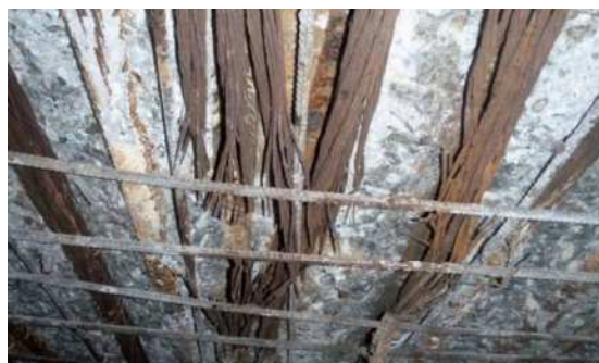
写真 1-4 妙高大橋 PC 鋼材破断状況
