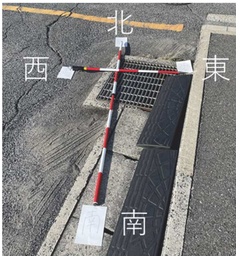
図 5-25 方位確認用赤白ポール
