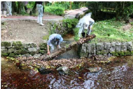
図 34 揚水量を調整する矢束(やた)の設置 (Mine 秋吉台ジオパーク推進協議会)
