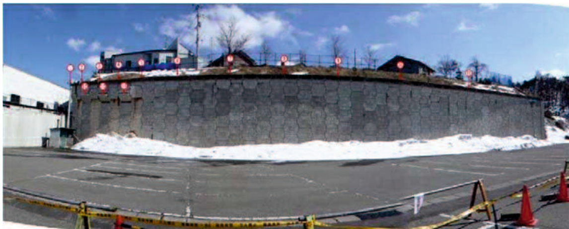
写真-2.1 被災事例①の全景
