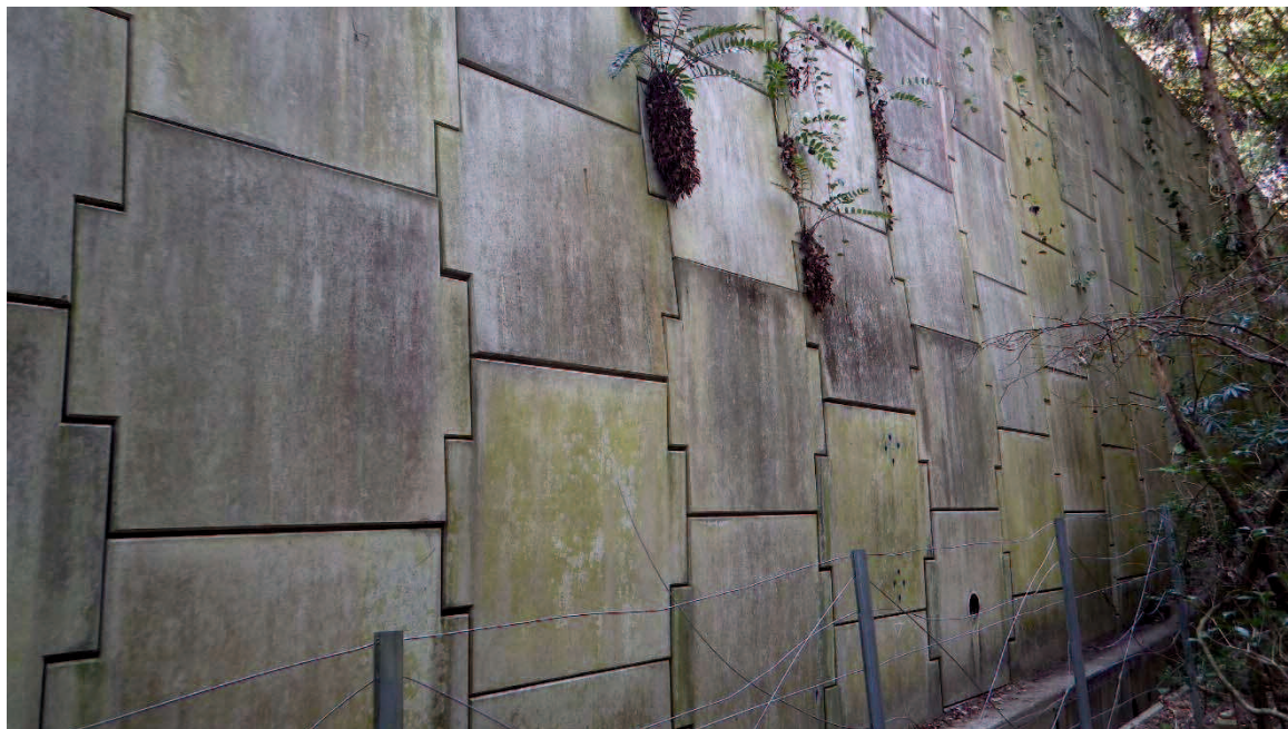
写真-2.11 壁面のはらみ・折れ(1)
