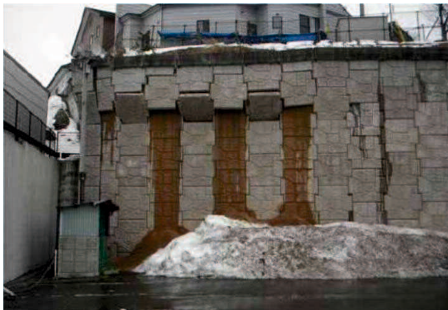
写真-2.2 被災事例① 被災箇所正面
