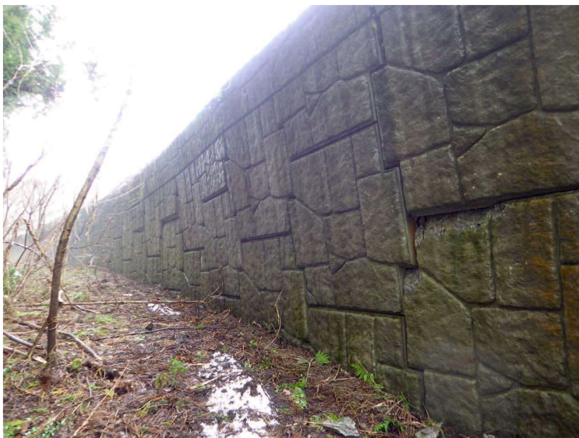
写真-2.12 壁面のはらみ・折れ(2)
