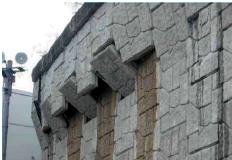
写真-2.3 被災事例① 被災箇所側方
