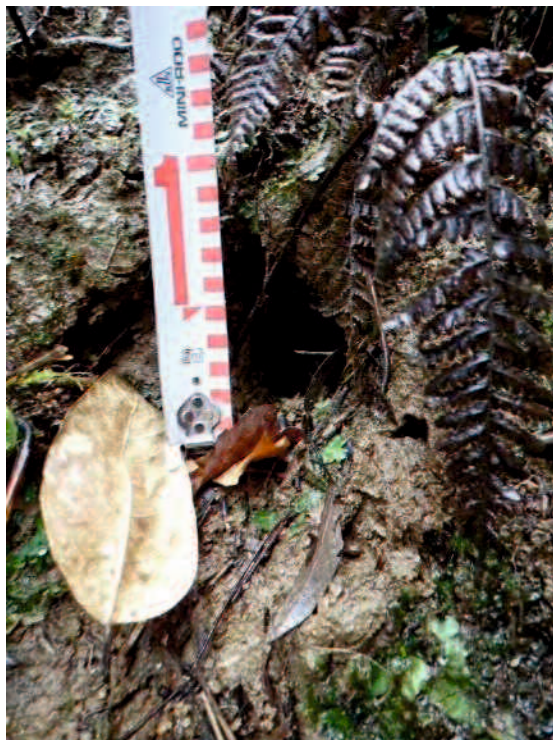
写真 1.3 堤体表のり面に開いた入口とみられるパイピング孔 (山口県下関市船引ため池)
