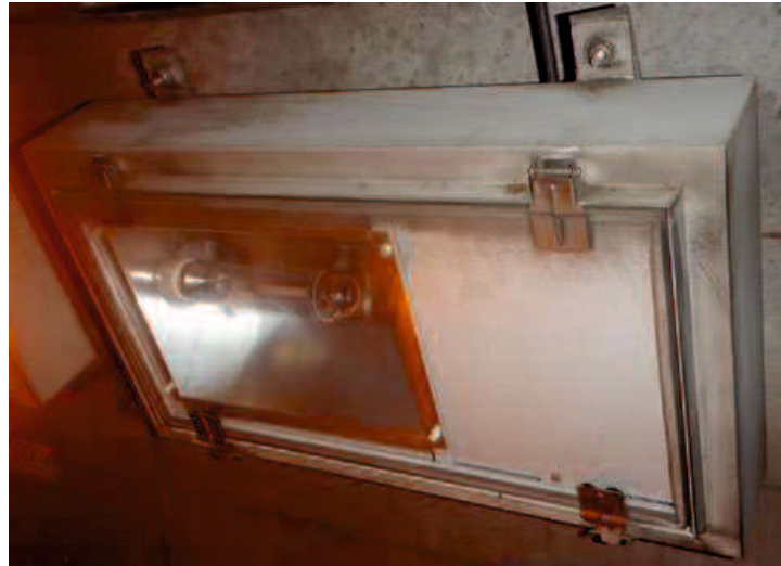
写真-3.1 トンネル照明設備
