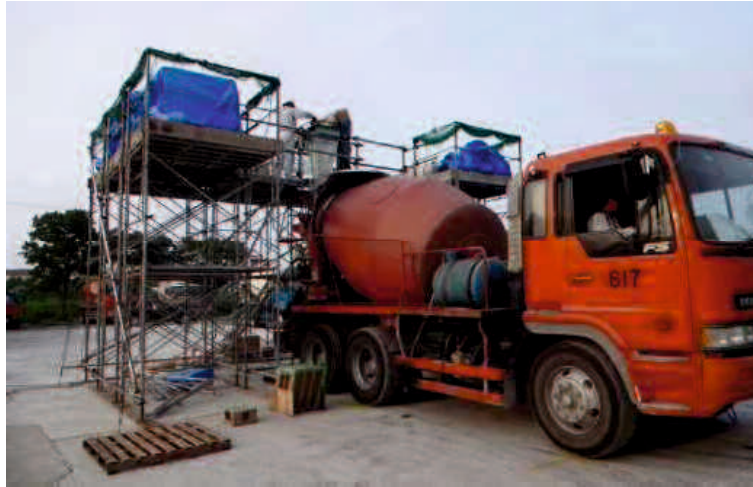
写真-5.4.2 鋼繊維投入場の外観
