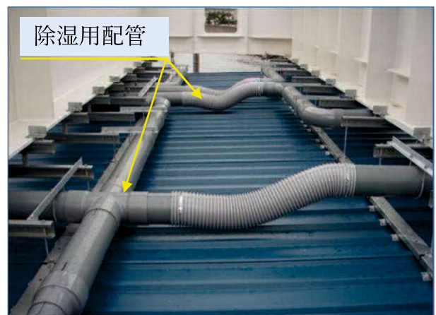
写真-2.9 桁内部と除湿用配管 48)
