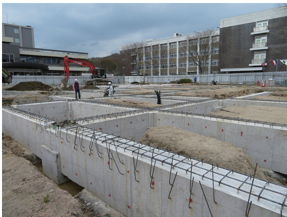
写真 214 破壊状況の確認(南西から)
