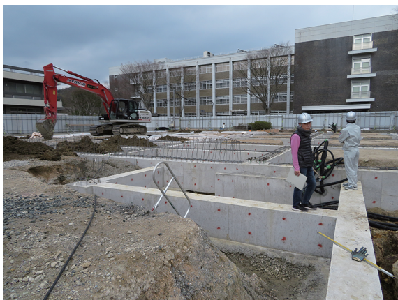
写真 215 破壊状況の確認(西から)
