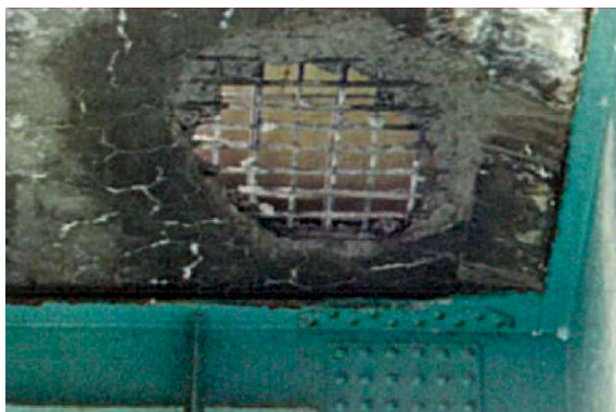
(c)疲労損傷の進行に伴う床版の陥没
