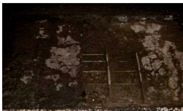
(b)水の侵入に伴う床版上面損傷例 (土砂化)
