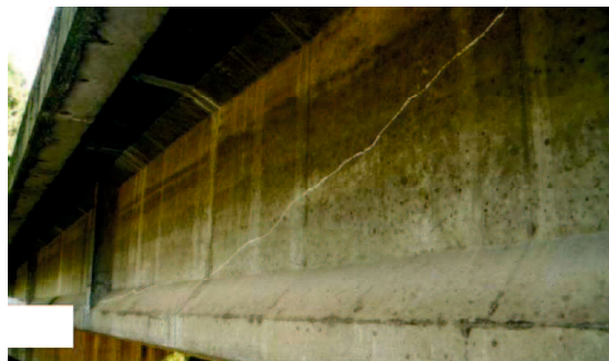
(c)シース内水の侵入にともなる PC 桁損傷例
