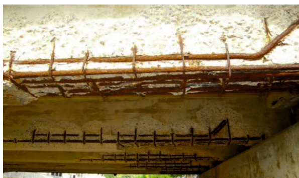
(b)塩害環境下でのコンクリート桁損傷例
