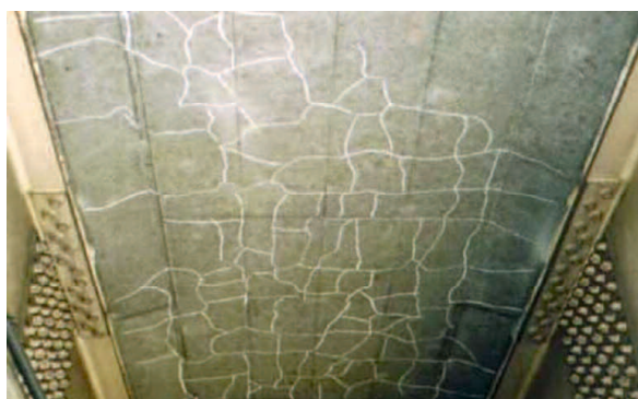
(a)疲労損傷による床版下面損傷例 (ひび割れ)
