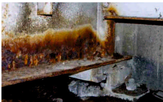
(a)桁端部滞水に伴う鋼桁桁端部損傷例
