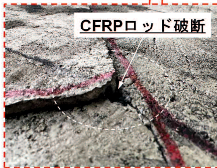
推抜きせん断破壊部
