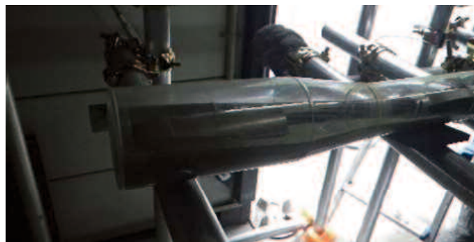
図-3.5.4 グラウト材の流出
