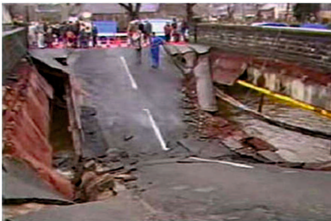
図-1.16 Ynys-y-Gwas 橋の落橋事例 12)
