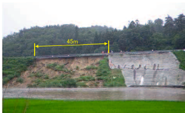
写真 2-8 被災盛土の全景(左:無対策, 右:応急復旧済)
