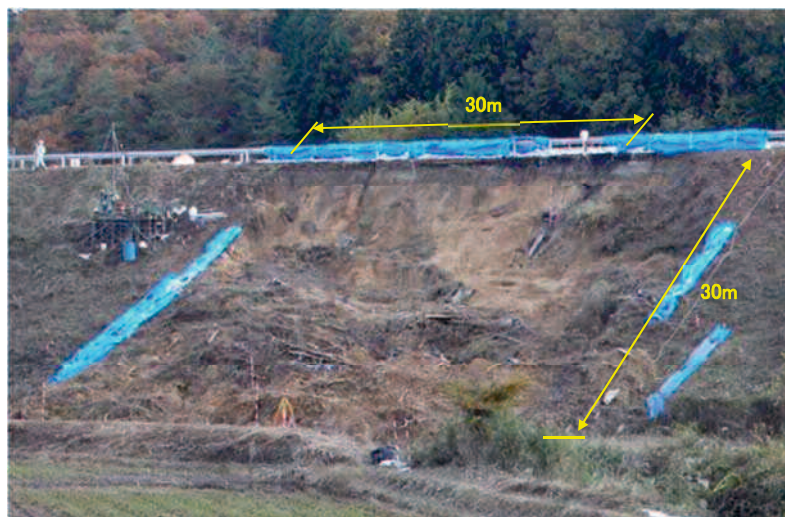
写真 2-1 被災盛土の全景
