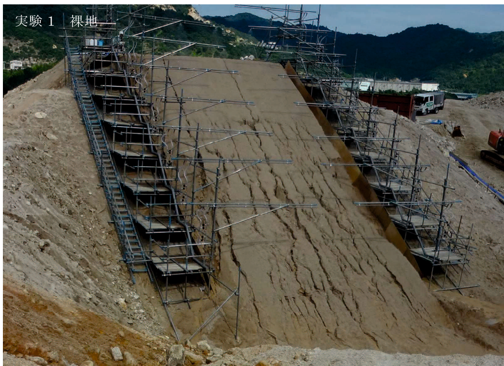
写真-5.5 降雨開始から2時間後の斜面状況（その1）
