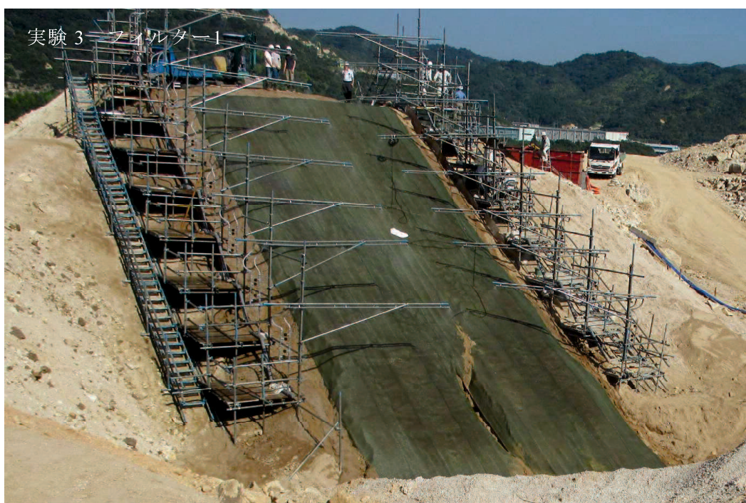
写真-5.5 降雨開始から2時間後の斜面状況（その2）
