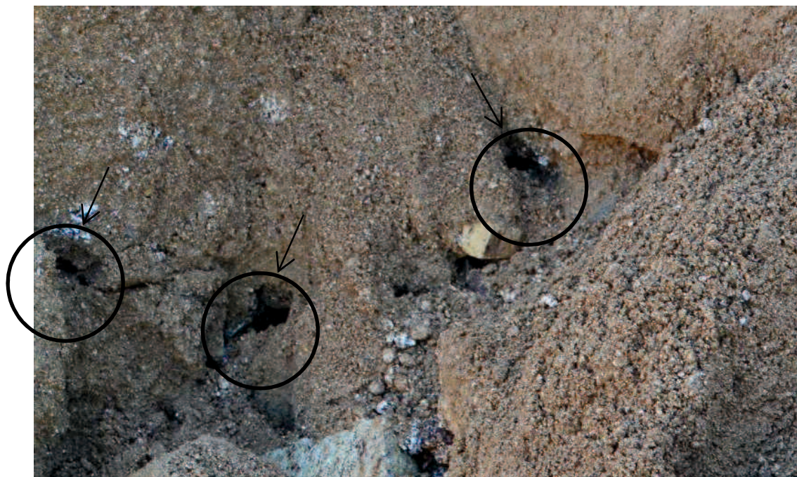
写真-5.6 ボイリング崩壊内に見られるパイピング
