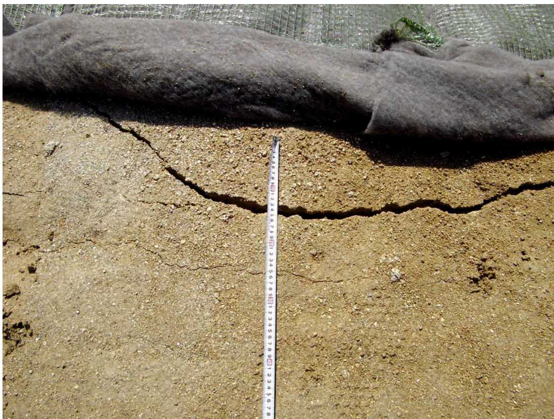
写真-5.7 実験4終了後に観察された法肩部の亀裂
