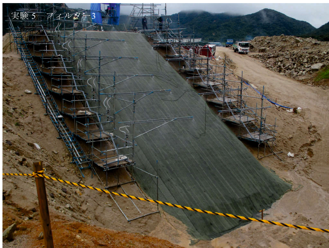
写真-5.5 降雨開始から2時間後の斜面状況（その3）
