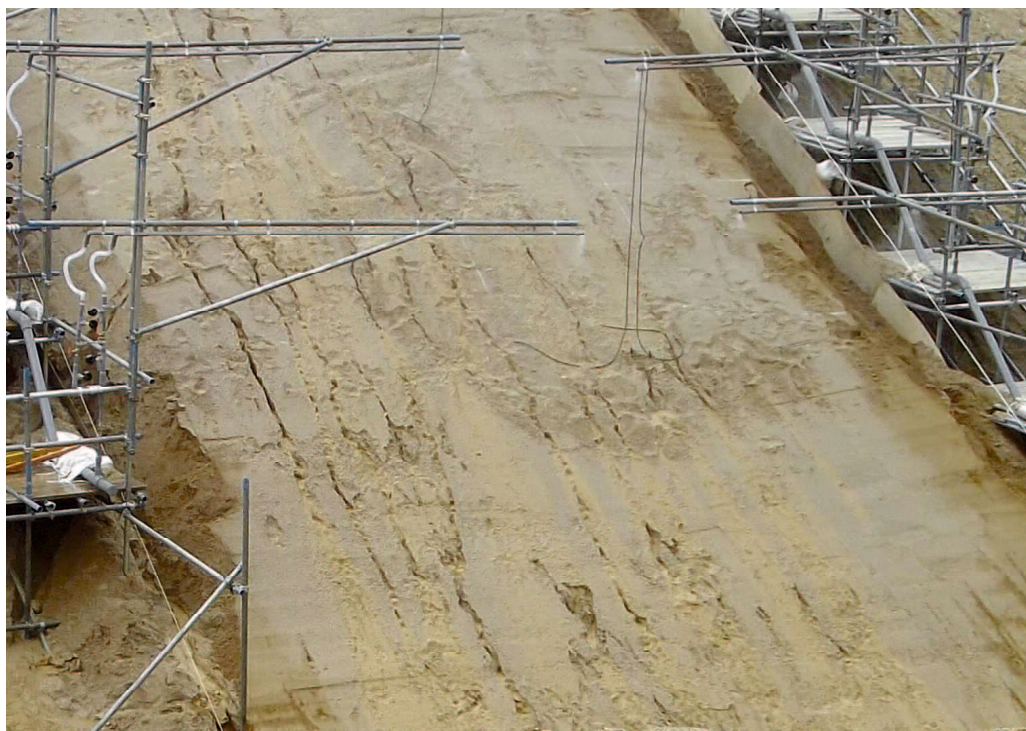
写真-5.2 ガリー侵食発生状況（実験2）
