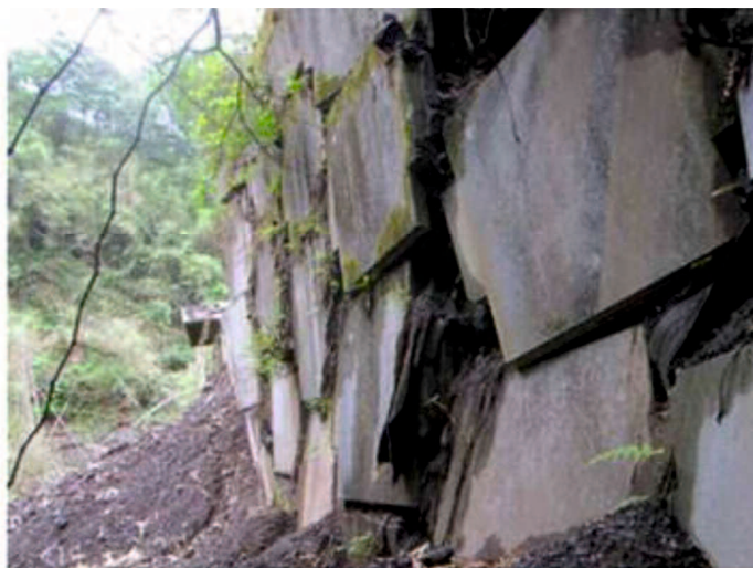
写真-5.4.5 自立性を保った状態で崩壊した補強土壁の壁面状況
