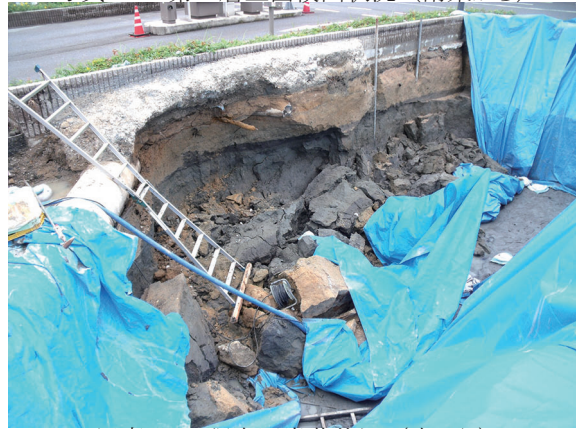
写真111 調査区崩落状況(東から)
