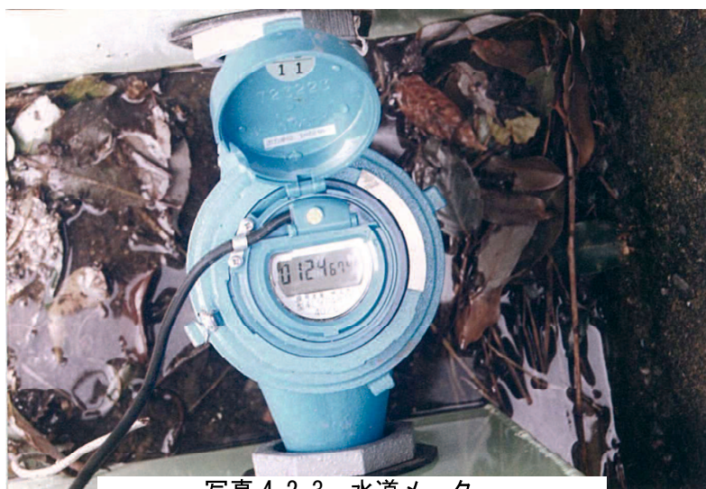
写真 4-2-3 水道メーター
