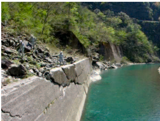
写真 5-6 護岸擁壁変状 (2005 年)
