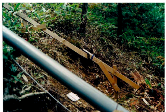
写真5-3 U地区冠頭部の段差開口亀裂
