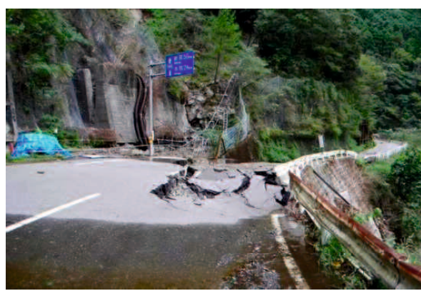
写真 5-7 2011 年 12 号台風直後の変状
