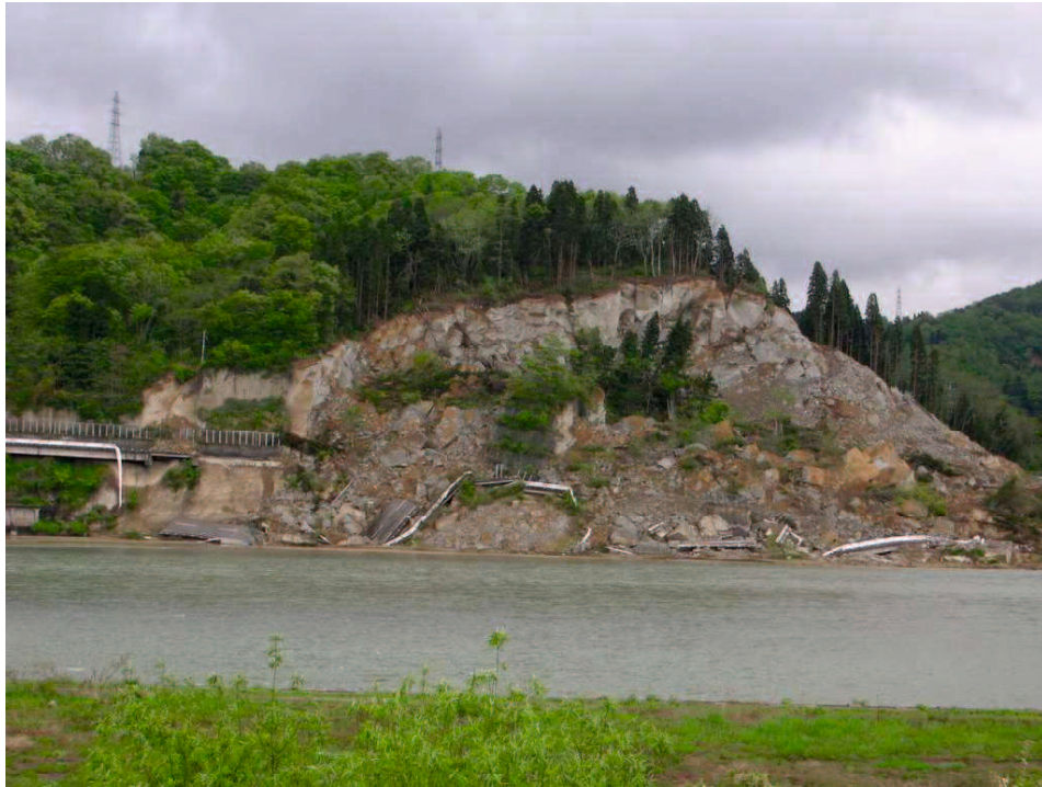
写真 3-1 2004 年 10 月 23 日 中越地震の際に発生した「地震時の深層崩壊」(長岡市妙見町)
