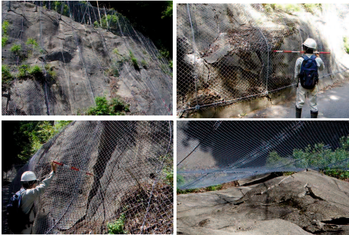
写真 5-12 奈良県 R 地区 崩壊前の吹き付け法面の亀裂状況
