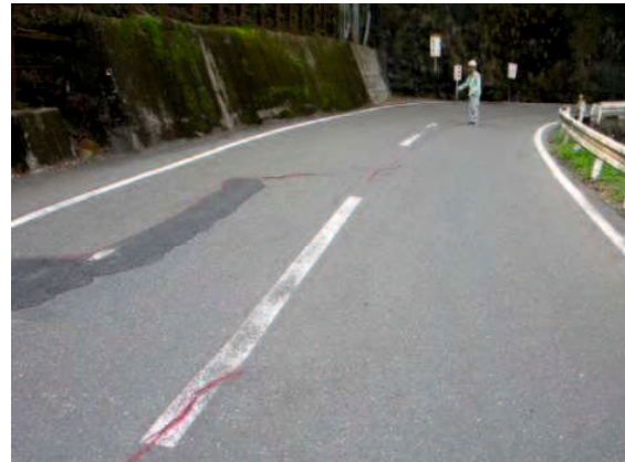
写真 5-5 道路を横断する亀裂 段差なし (2005 年)
