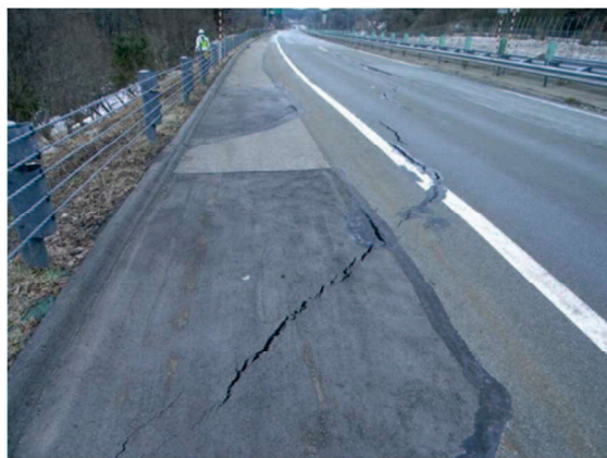
写真-5.4.1 路面の異常なクラック例
