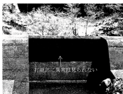
(e) 副ダムの堤体打継部（川崎，2014） 4)
