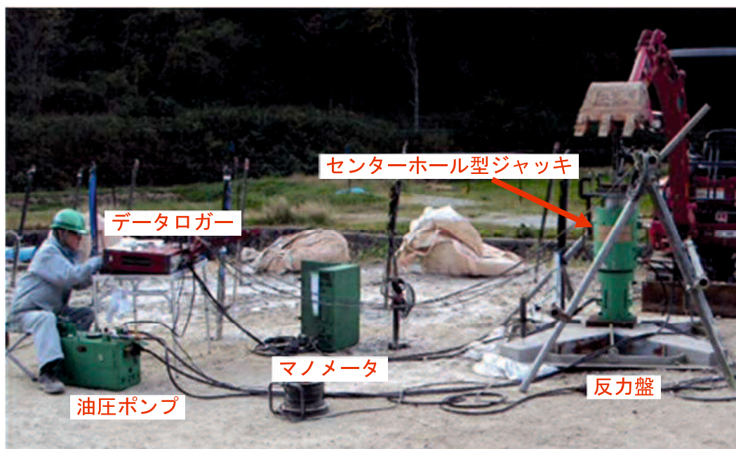
図 3.10 アンカー体の引抜き状況
