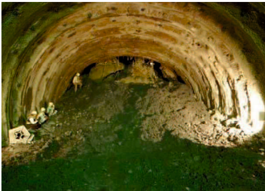
写真-1.1 湧水を伴う土砂が流出することにより切羽崩壊した事例
