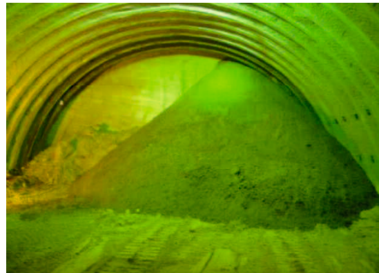
写真-1.2 地下水により土粒子の固結度が低下して土砂が流出した事例
