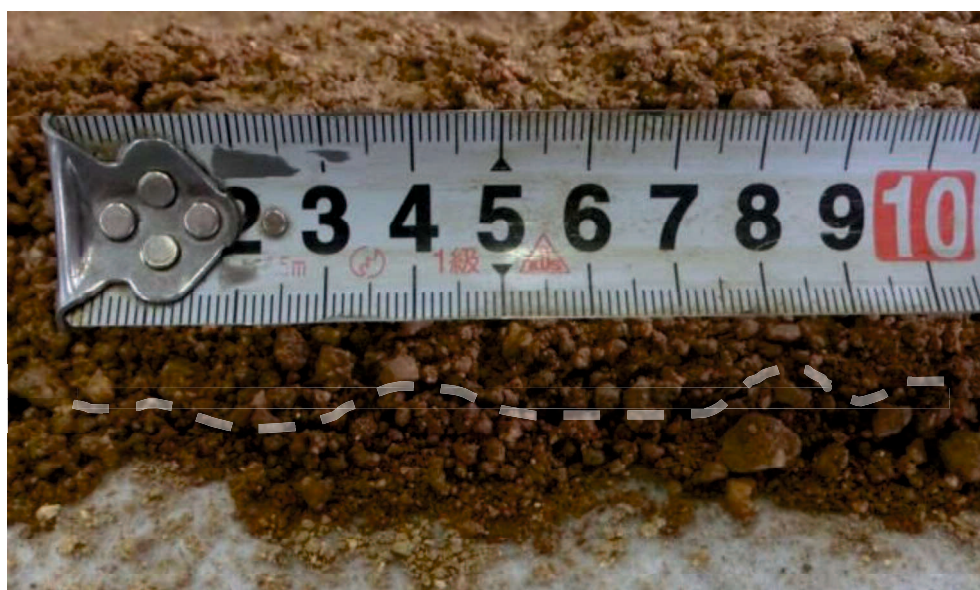
写真-5.6 亀裂 1 (10cm)
