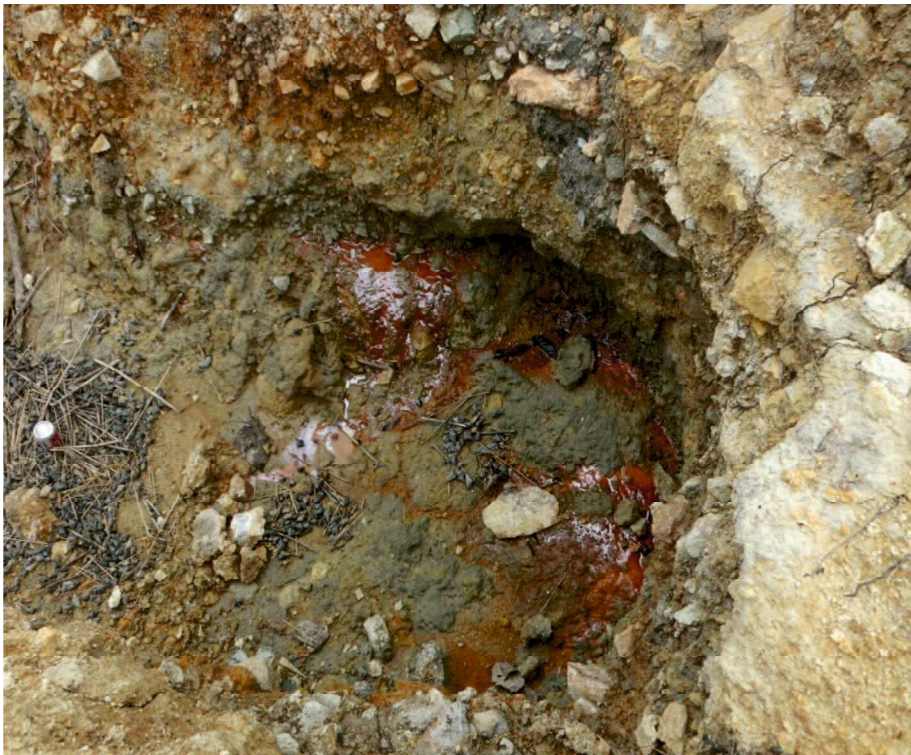
写真-1.2 堤体断面からの漏水
