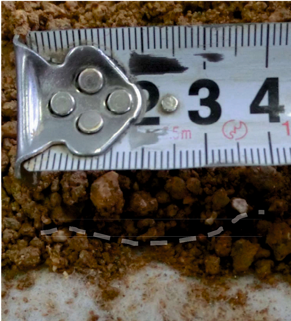
写真-5.7 亀裂2 (3.5cm)
