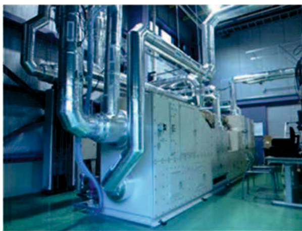
図 3-1 デシカント空調機（試作機）外観
