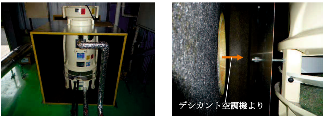
図 4-17 蒸発促進冷却塔
