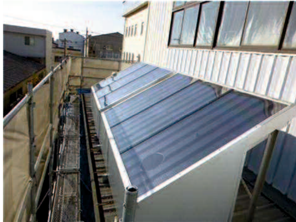
図 3-3 空気式太陽熱集熱器外観
