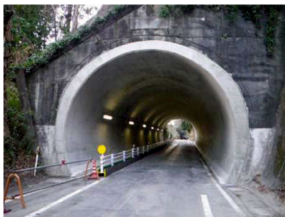
(覆エコンクリート施工完了, 鋼製支保工を内部に巻き込んでの打設)
