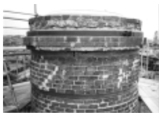
写真6 目地のひび割れ (南東側円筒部)
