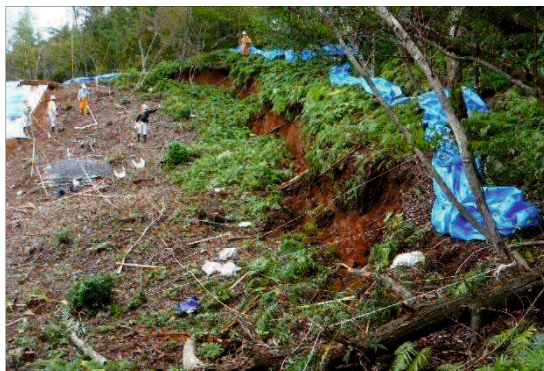
図-5.27 No.14 松江自動車道 松江玉造 IC～宍道 IC 切土のり面災害
