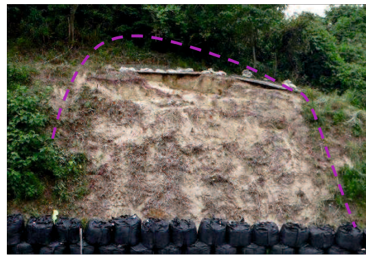
図-5.28 No.20 山陽自動車道 五日市 IC～廿日市 JCT 切土のり面災害
