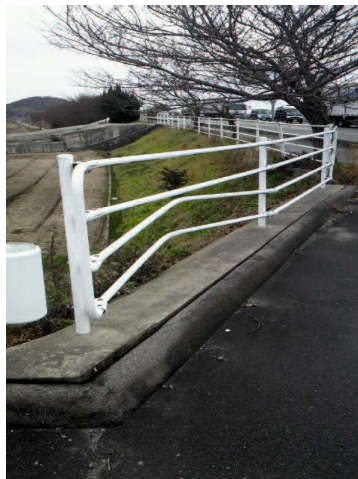
転落防止柵破損
