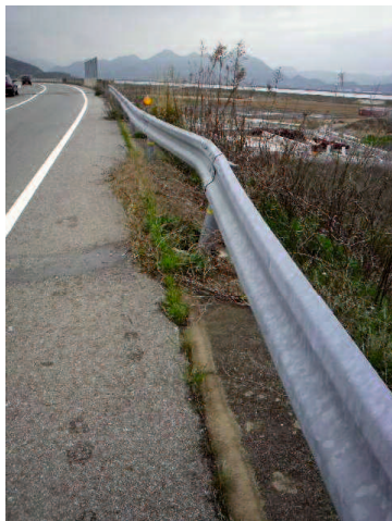
ガードレール破損
