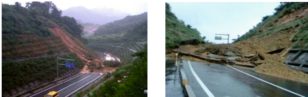
法面被災状況
