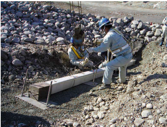
(a)ロックフィルダム堤体表面に埋設中の測定管
