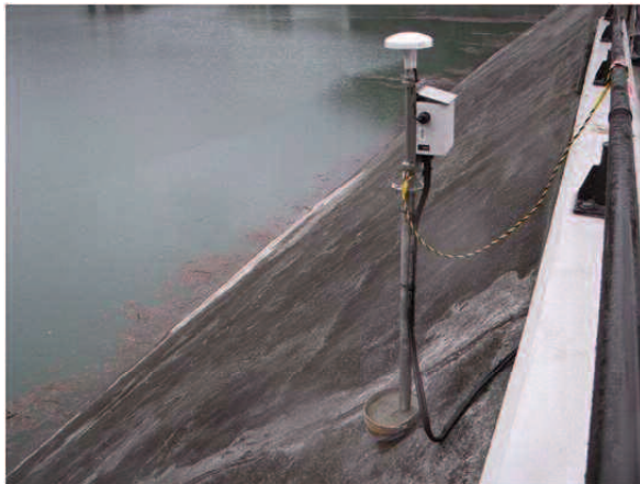
写真-5.1 ダム上流面のコンクリート遮水壁に設置した GPS センサー
