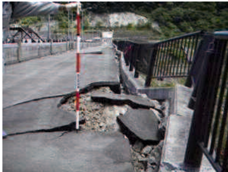
写真-2.2 天端高欄と舗装面との段差 (約 50cm) 14)
