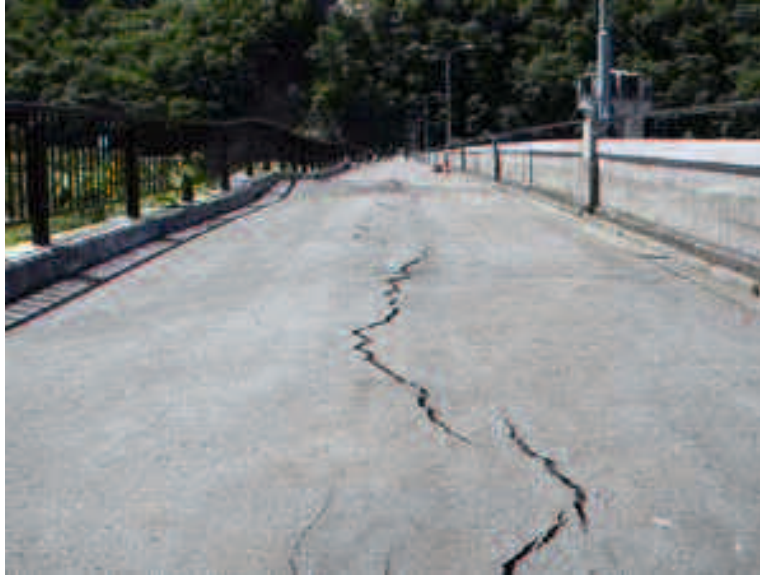
写真-2.1 天端舗装面の亀裂と”なみうち” 14)
