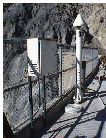
(b)DAM2 に設置した GPS アンテナ
