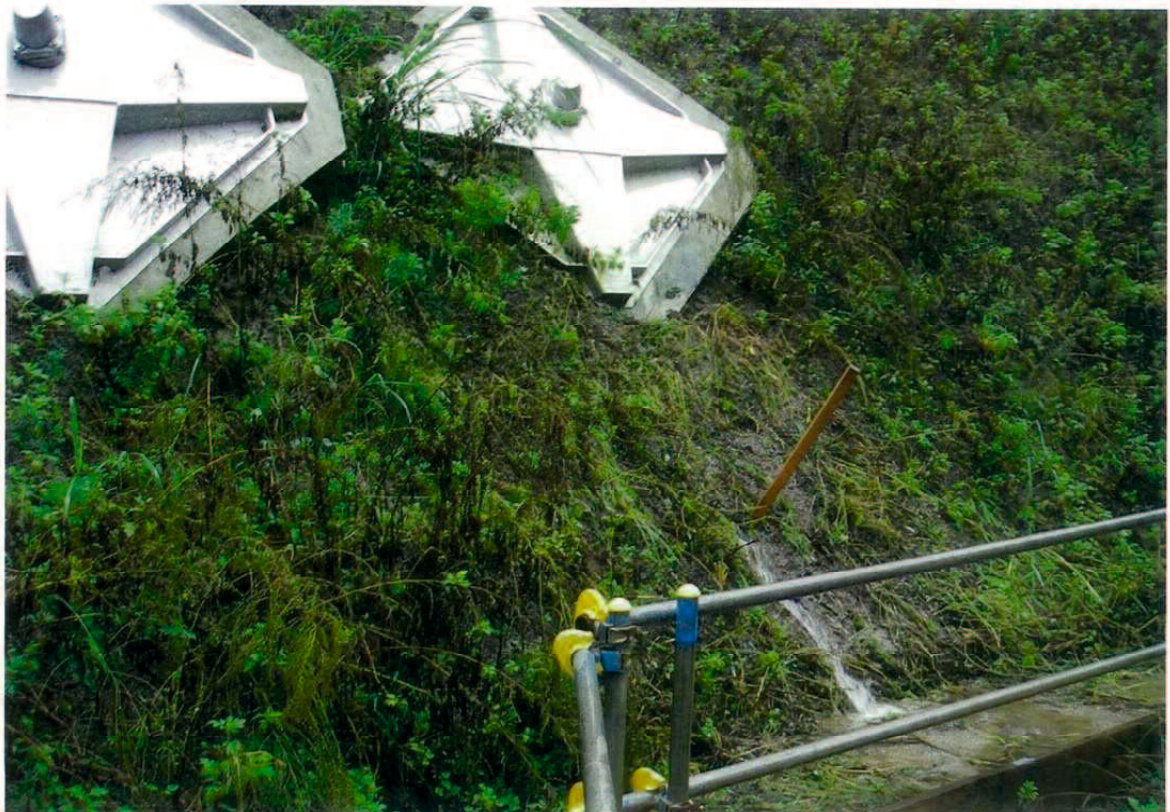
図-5.9 のり面からの湧水状況
