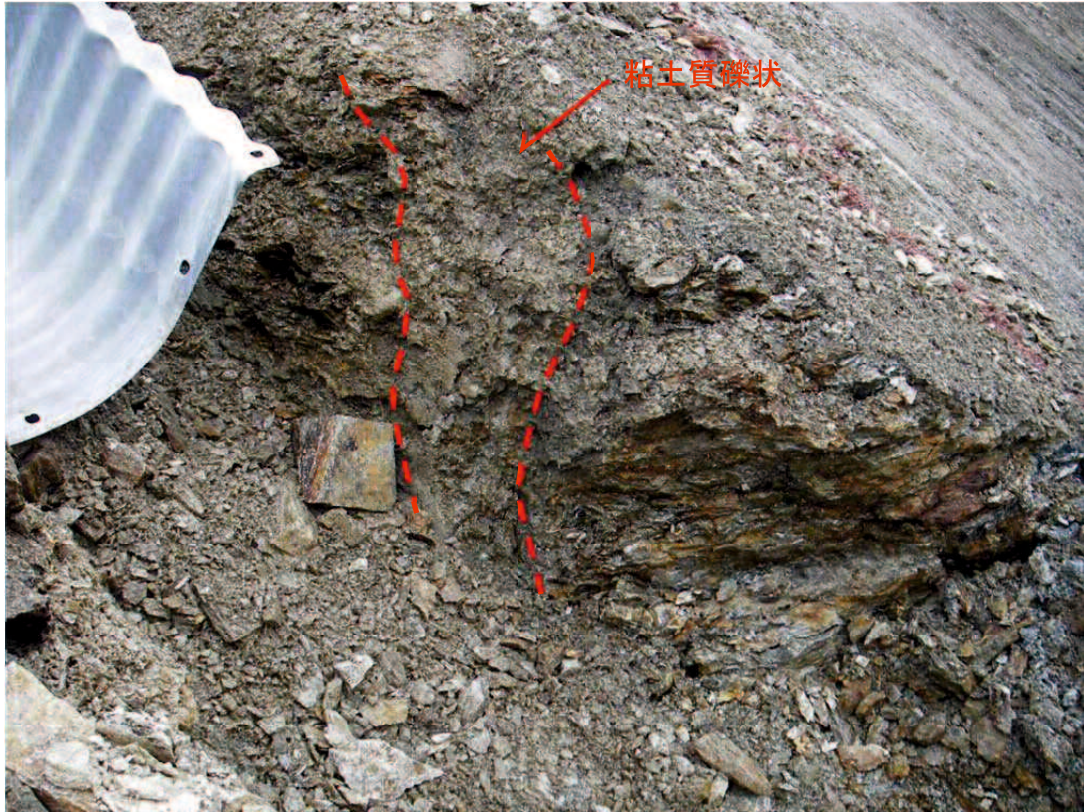
図-5.8 開口亀裂箇所での地下の性状（拡大）同上
