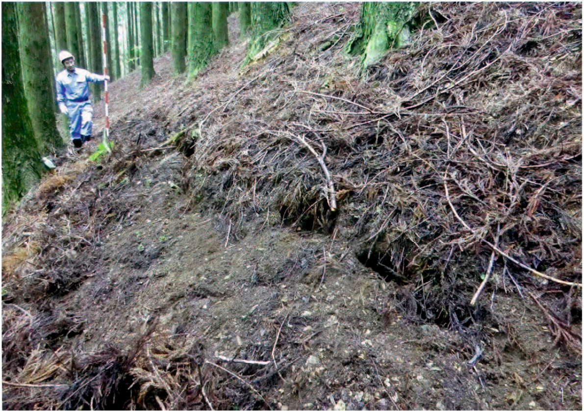
図-6.5 二畝の谷斜面の開口亀裂の状況
