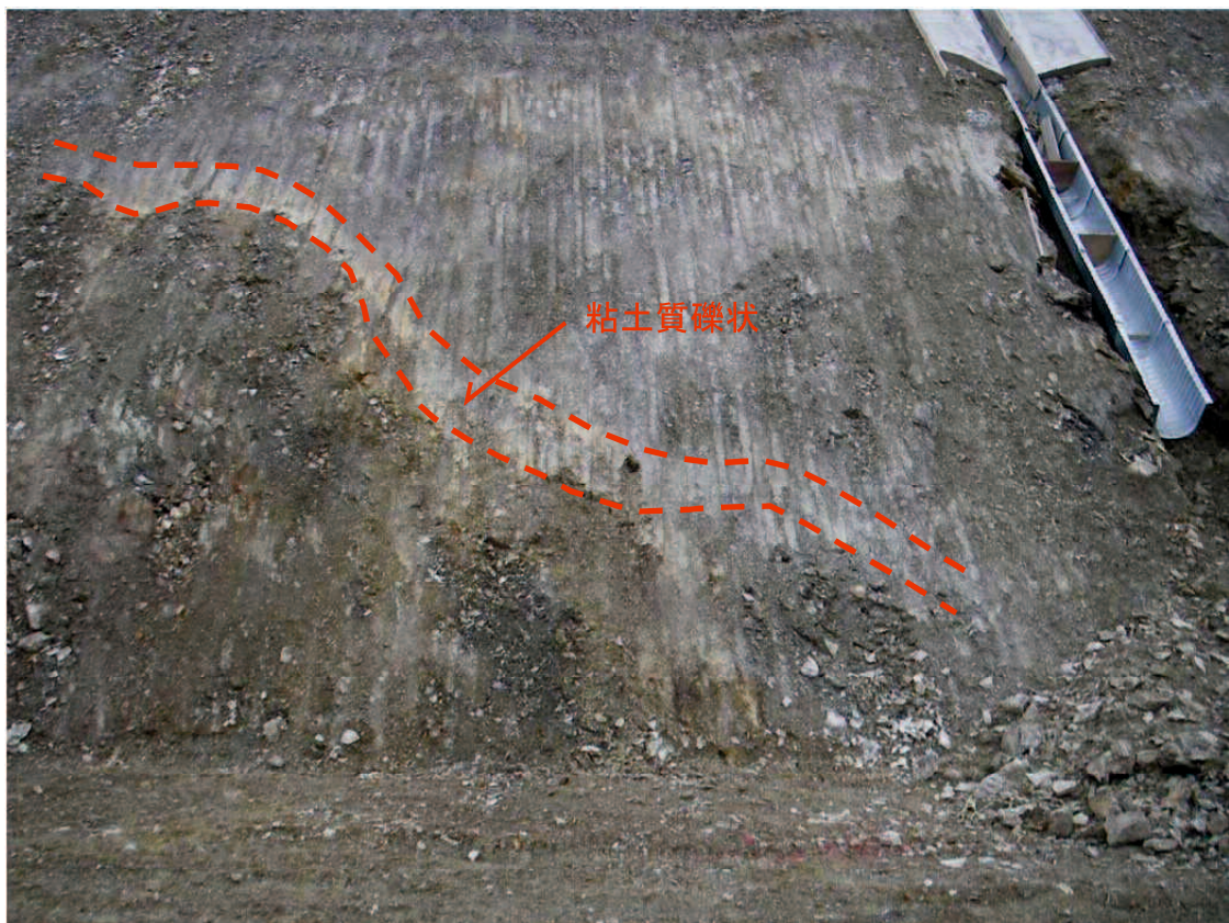
図-5.7 開口亀裂箇所の地下の性状 開口亀裂を図示する
