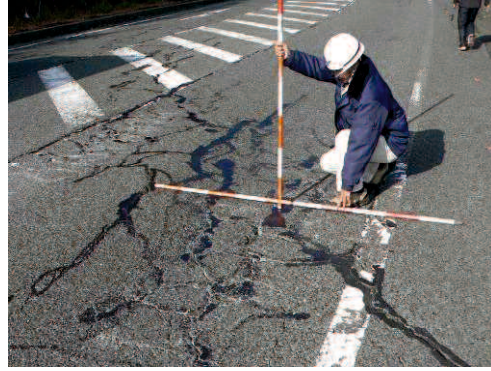
写真 3.5-7 車道のクラックと轍
