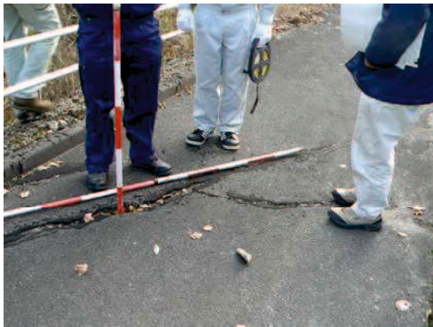
写真 3.5-8 歩道の開口クラック
