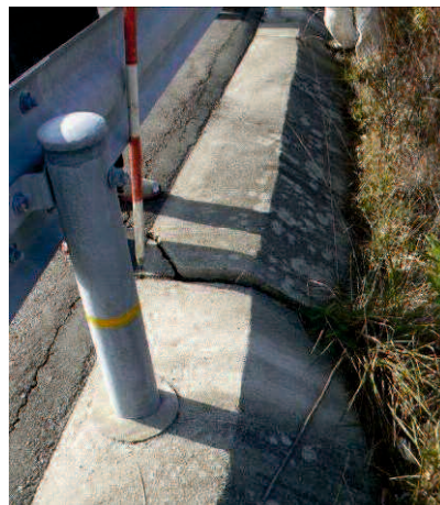
写真 3.5-21 路肩部のずれ
