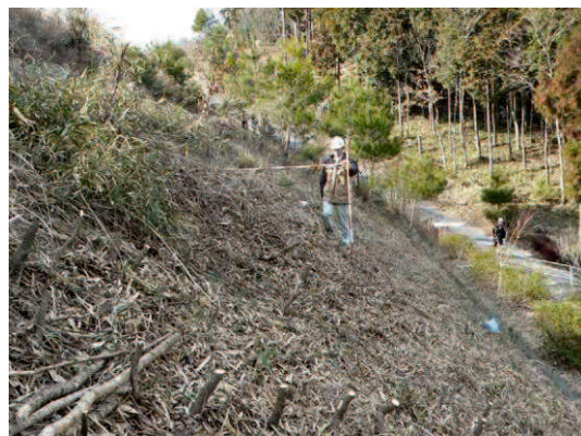
写真 3.5-5 ①法面のはらみ出し
