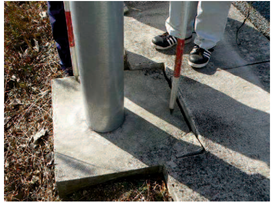
写真 3.5-14 道路標識の沈下
