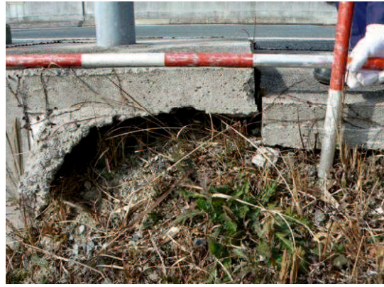
写真 3.5-13 盛土部と橋梁部のずれ①
