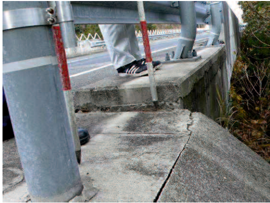
写真 3.5-14 盛土部と橋梁部とのずれ②
