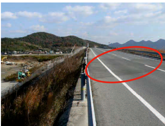
写真 3.5-21 ガードレール波打と路面補修跡
