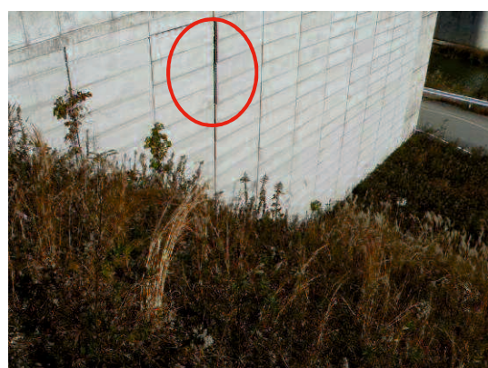
写真 3.5-22 橋台のはらみ出し
