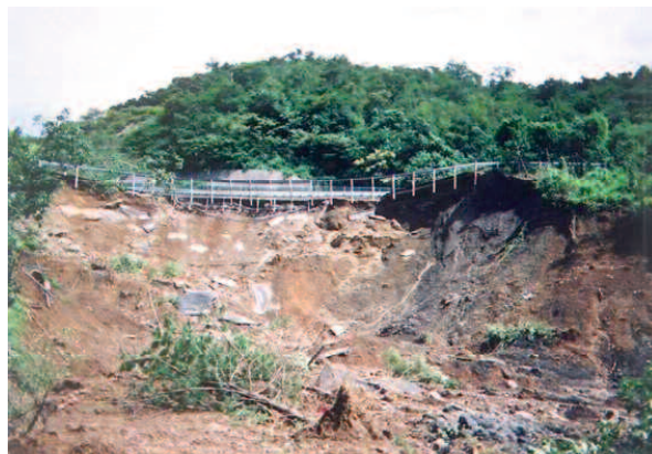
写真-1 山陽自動車道の崩壊 3)
