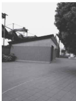
トイレ左傾斜 屋根下
