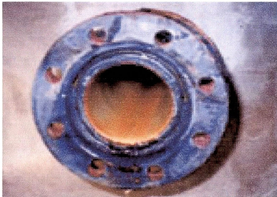
写真-1.3 金属が付着した管路 9)
