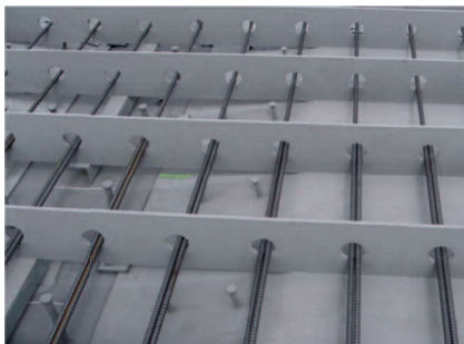
(a) 内面の無機ジンクリッチペイント
