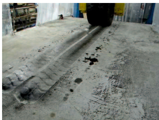
(a) 表面状態 (ひび割れなし)
