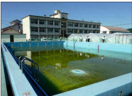
写真4-3 給水施設(プール)
