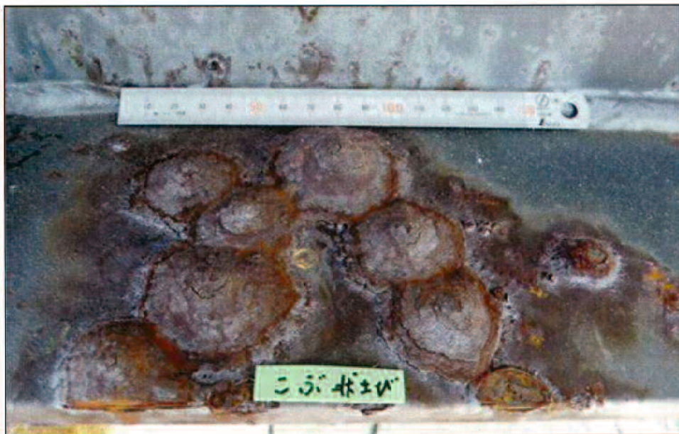
写真-3.3 こぶ状さび生成状況
