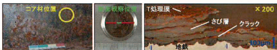
(e) 外観評点2-y, T処理膜部分的に残存, さび層には縦横にクラック発生し, 一部剥離さびあり
