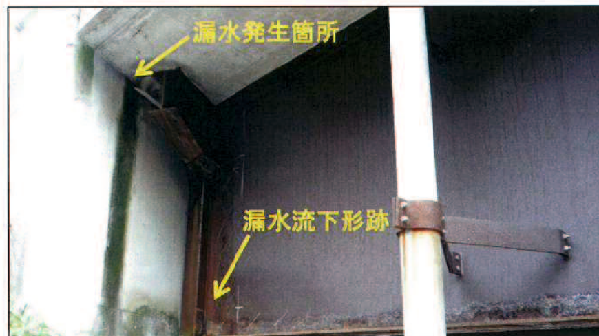
(a) 漏水発生箇所と流下形跡に沿った層状剥離さび山根橋全景
