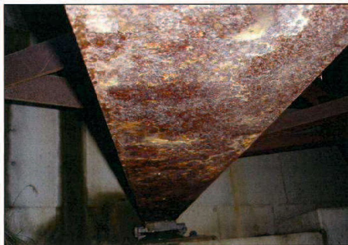
(b) 下フランジ下面の層状剥離さび
