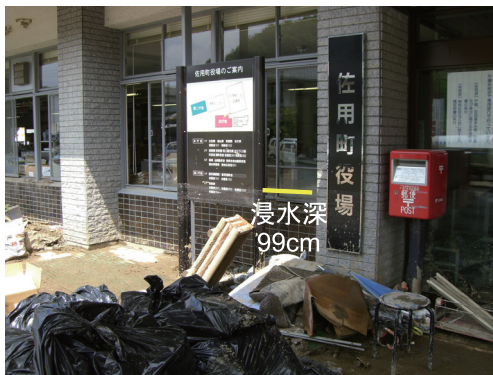
写真6 佐用地区の佐用町役場における浸水被害の状況 (佐用町佐用, 2009年8月11日撮影)
