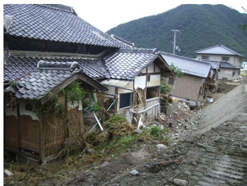
写真13 久崎地区における破堤による住家基礎の洗掘の状況 (佐用町久崎, 2009年8月11日撮影)
