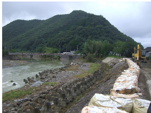
写真12 久崎地区における佐用川左岸の破堤の状況 (佐用町久崎, 2009年8月11日撮影)
