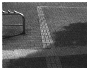
Fig. 5 正門点字ブロックの途切れ 改修後にもかかわらず途切れている。
