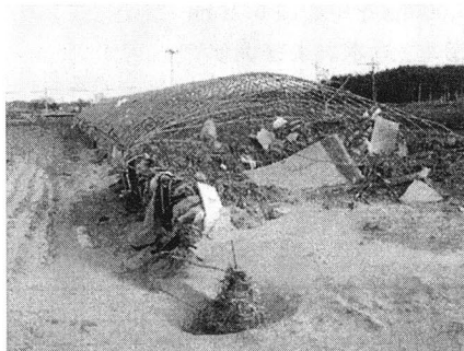
写真2 農業用ハウスの倒壊(図7の②)
