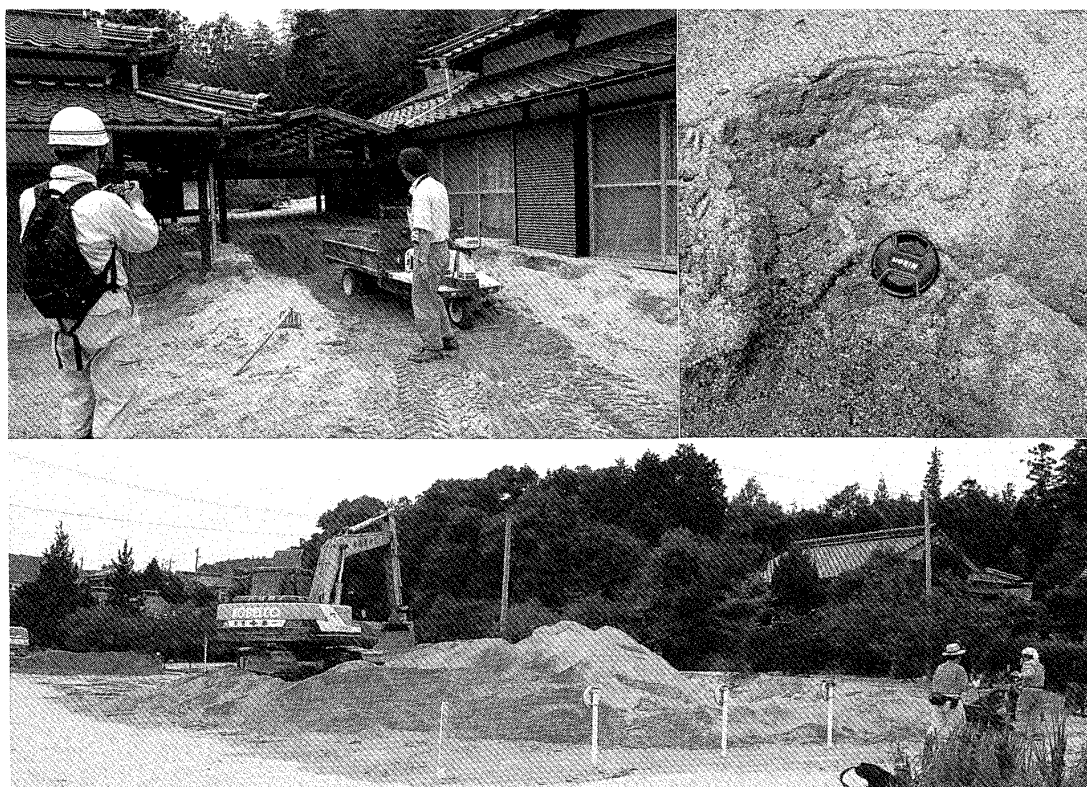
図21 上左：十七地区で土砂に埋まった家屋の例。この家屋のすぐ上に渓流がある。上右：堆積したマサ砂。縞構造は何度も流出，堆積したことを示す。下：宅地内に堆積した砂を周辺の道路に排出，山積している状況。
