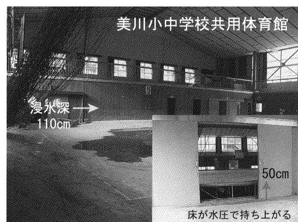
写真1 美川小中学校共用体育館における浸水被害の状況（山口県玖珂郡美川町南桑，2005年9月25日撮影）
