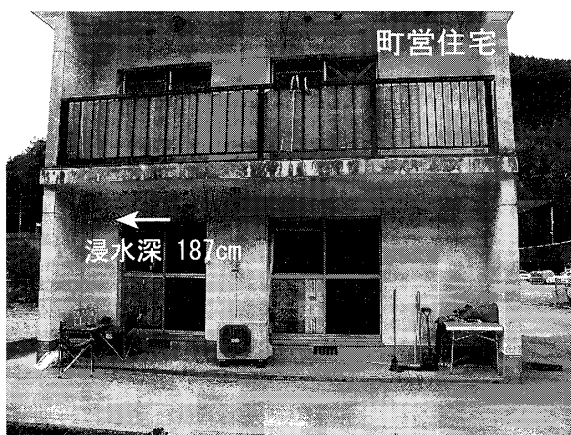
写真3 美川町町営住宅における浸水痕跡（山口県玖珂郡美川町南桑，2005年9月25日撮影）
